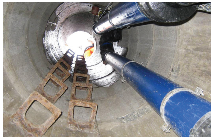
Sewer heat, Cologne, Germany. Photo by Stadtentwässerungsbetriebe Köln, AöR.
