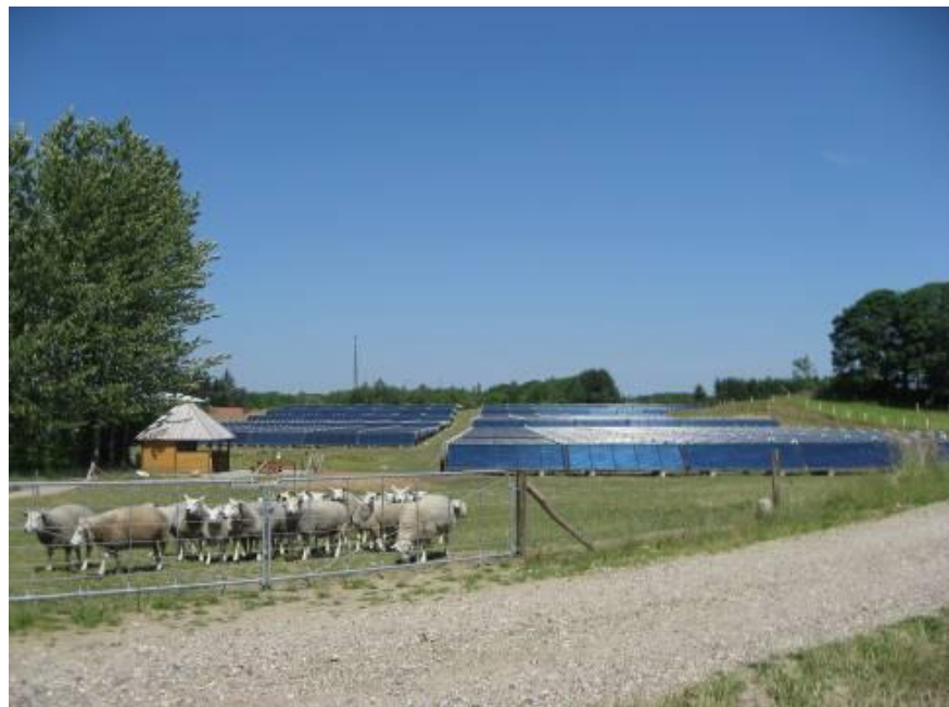
Figure 93. Brædstrup DH plant with 8,000 m 2 solar collectors. Photo Brædstrup Fjernvarme.
