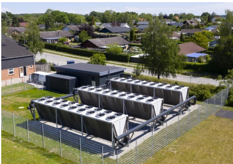
Figure 7. Example of V-shape evaporators at Slagslunde Fjernvarme.
